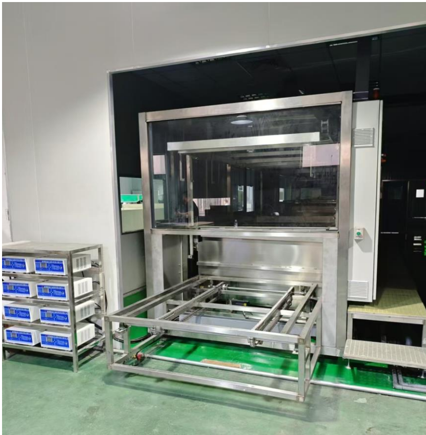
清洗線 Cleaning line
